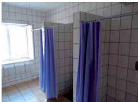
Wygodzone stanowiska kąpielowe w łazni (OZ Grodzisk Mazowiecki)
