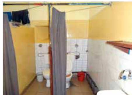
Kącik sanitarny w celi 19-osobowej (AŚ Bytom)
