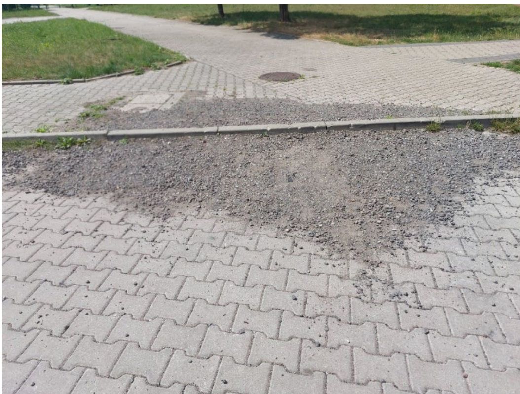
Zdjęcie 16. Parking przed lokalem wyborczym. By przejść na chodnik trzeba pokonać wysoki krawężnik. Pod krawężnikiem podsypano żwir, po którym wjeżdża się na chodnik.
