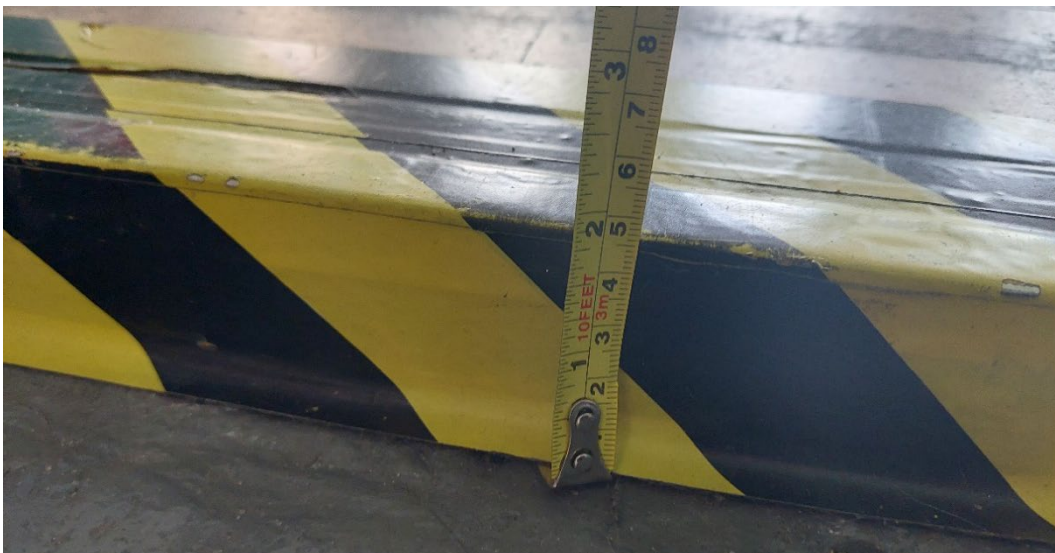
Zdjęcie 9. Próg drzwi prowadzących do lokalu wyborczego o wysokości 5 centymetrów.
