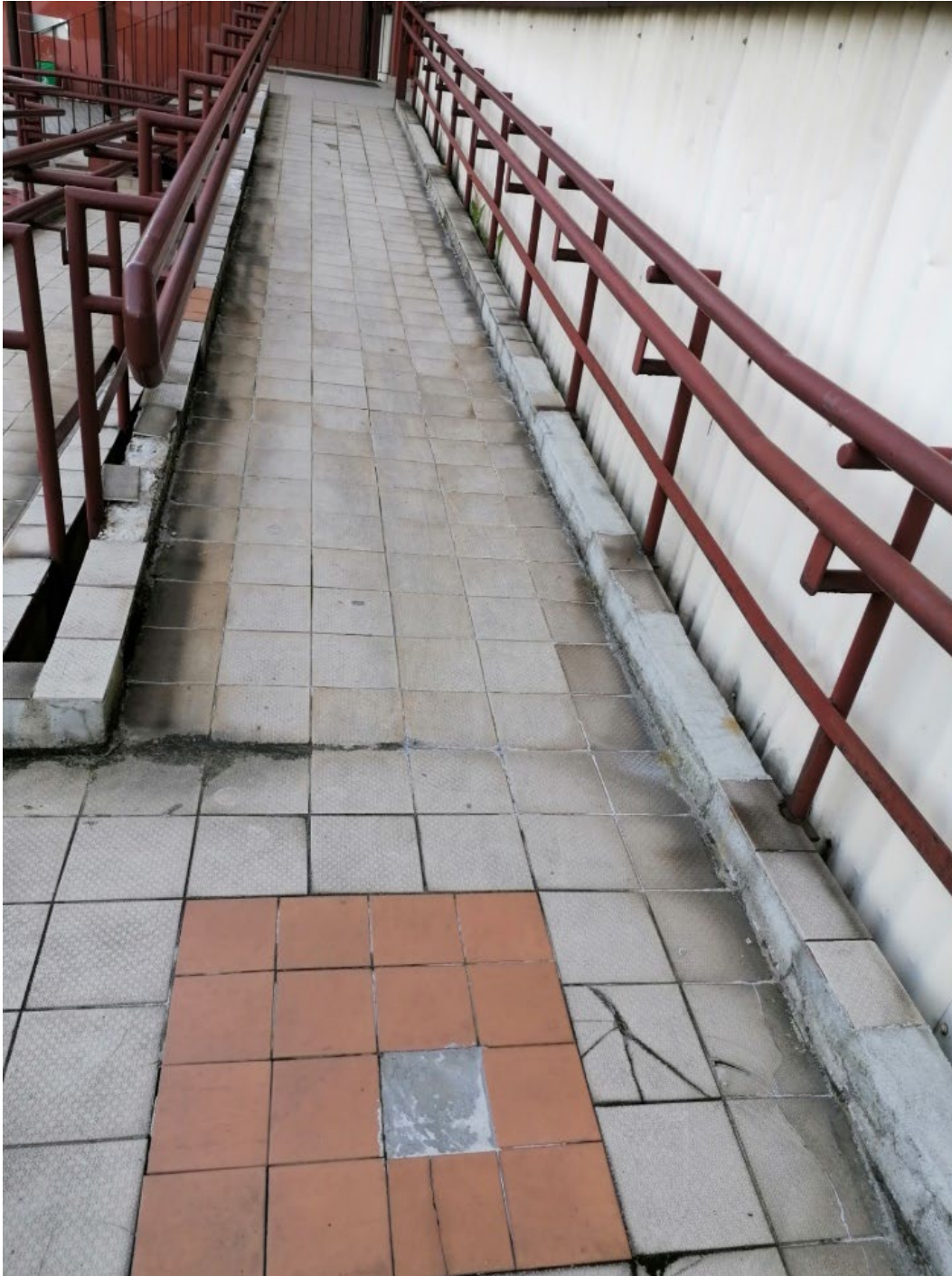
Zdjęcie 19. Podjazd dla wyborców z niepełnosprawnościami, którego podłożem są płytki ceramiczne. Część z płytek jest rozbita, części brakuje, część jest zarośnięta mchem.
