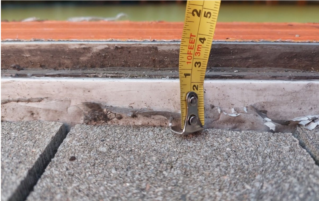
Zdjęcie 8. Próg drzwi prowadzących do lokalu wyborczego o wysokości 4 centymetrów.
